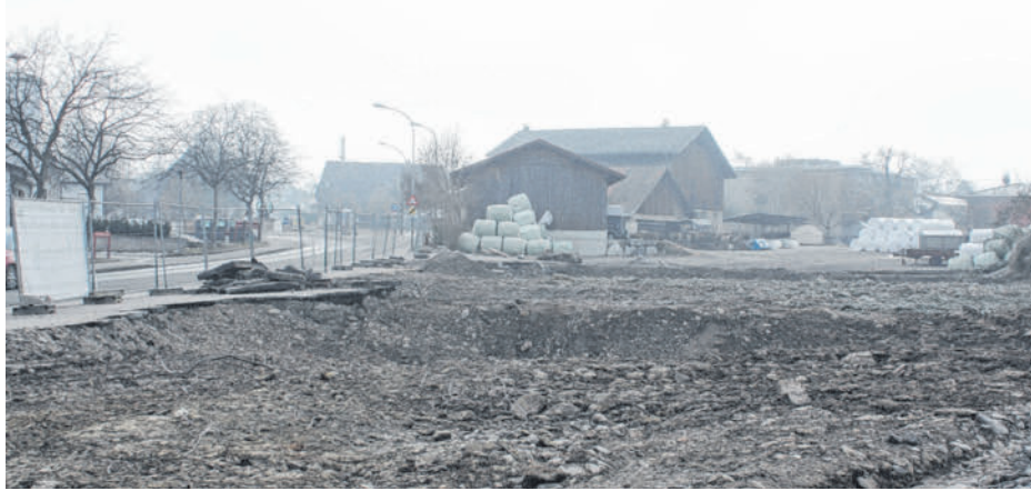
Das Firmengebäude der Tischlerei wurde im Dezember abgerissen. Ab März wird gebaut.
